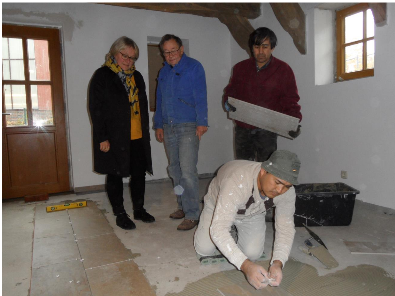
Sykes Bürgermeisterin Suse Laue lässt sich informieren; Ali Hussaini und Rashid Gamali legen die Fußbodenfliesen nach Anleitung durch den Bauleiter Bernd Brümmer und Helmut Schulz (nicht auf dem Foto).
